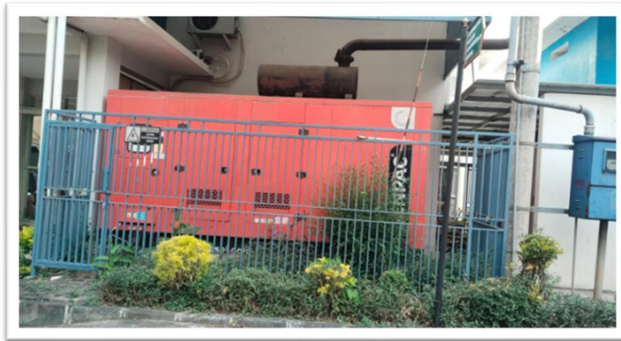
Gambar 31. Genset 250 Kva Sebagai Sumber Daya Cadangan
